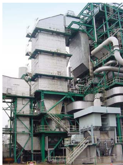
排煙脱硝装置
