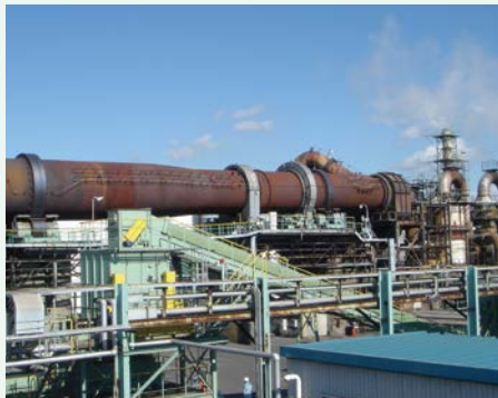
JX金属苫小牧ケミカル ロータリーキルン式焼却炉
