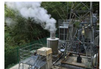
下田温泉バイナリー発電所
