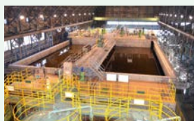
豊羽鉱山 本山坑廃水処理場の様子
