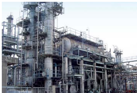
排煙脱硫装置
