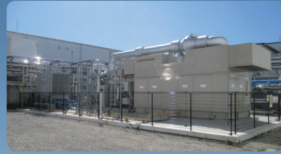
ガスエンジンCGS
