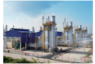
ペトロナス ベナピサン(マラッカ) コージェネレーションプラント プラント設備(マレーシア)
