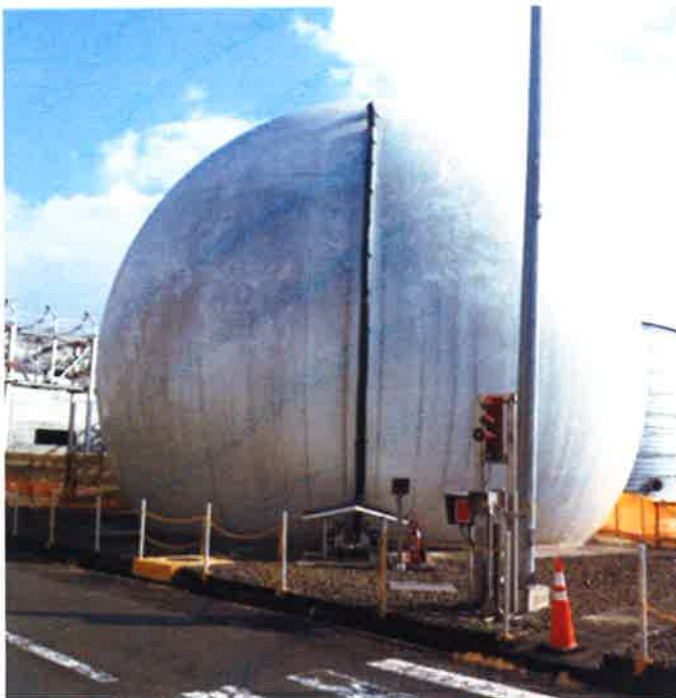
Gasómetro estructura utilizada para almacenamiento de biogás que es enviado a cogeneración
