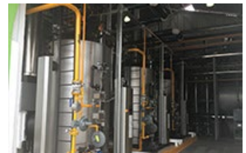
ビームサントリー Sauza(メキシコ)工場の 新設貫流ボイラー
