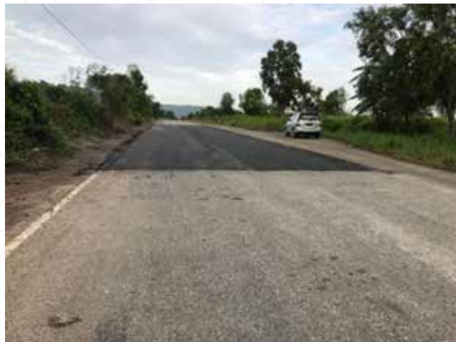
Perbaikan Jalan Soewandi (overlay dan patching) sebagai jalan penghubung Jalan Soekarno-Hatta dengan Jalan Poros Sangatta-Bengalon
