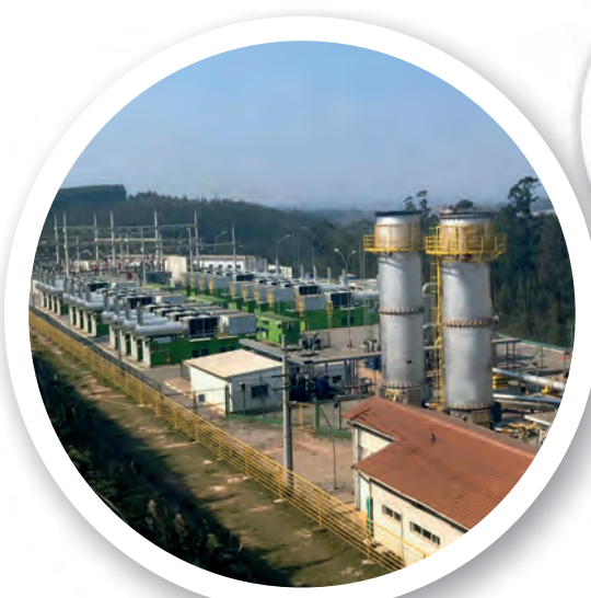
UVS Termoverde Caieiras Caieiras - SP
