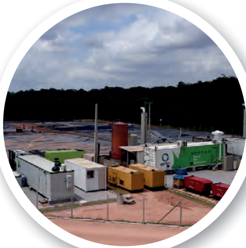
UVS Guamá Tratamento de Efluentes por Osmose Reversa Marituba - PA
