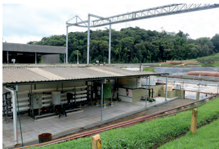
UVS Essencis Joinville ETE - Tratamento de Efluentes Convencional - detalhe da nanofiltração
