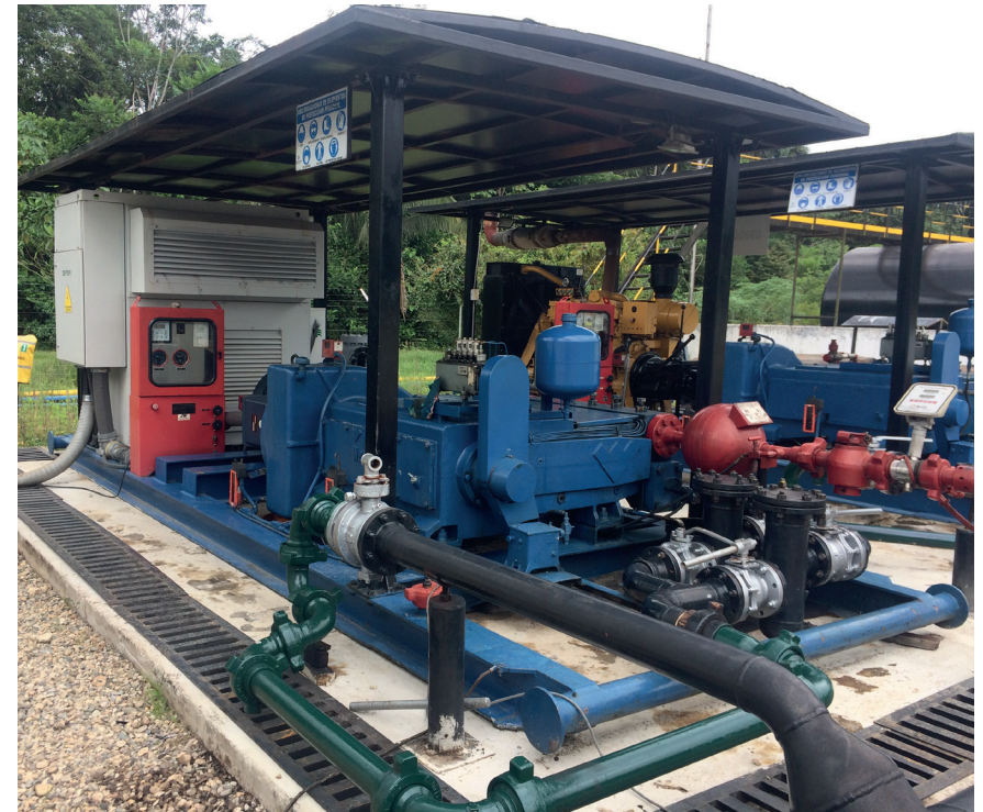
Unidad de Bombeo Hidráulico – UBH
