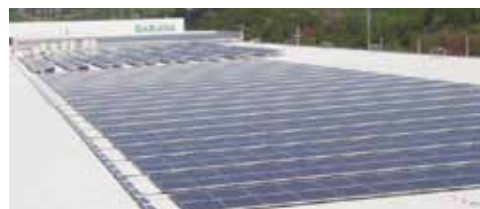
伊賀工場ソーラーパネル
