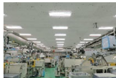
山形カシオ工場のLED照明
