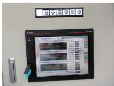
①COD・リン自動監視装置 (名古屋工場・岐阜工場)
