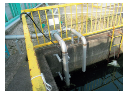
③貯留槽による排水の場外流出防止 (名古屋工場)
