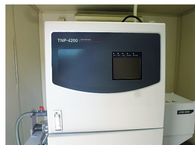
②全窒素自動監視装置 (名古屋工場)
