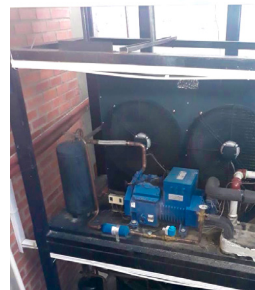
FOTO: Chiller marca TECMA
