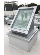
光ダクト (採光口)
