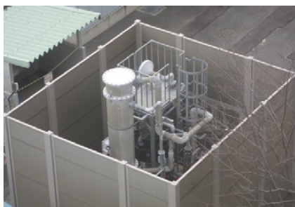
本社事業所の地下水浄化装置
