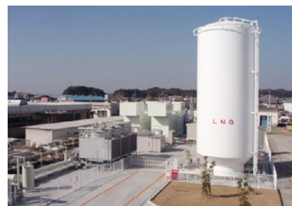
掛川工場のコジェネレーション設備
