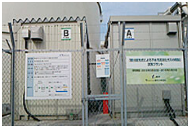
横浜市北部汚泥資源化センターに設置した バイオガス精製試験装置
