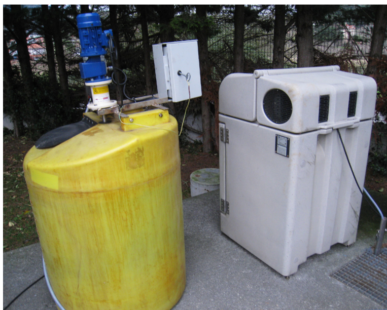
Lekeitioko HUA n usainen kontrola • Control de Olores en la EDAR de Lekeitio
