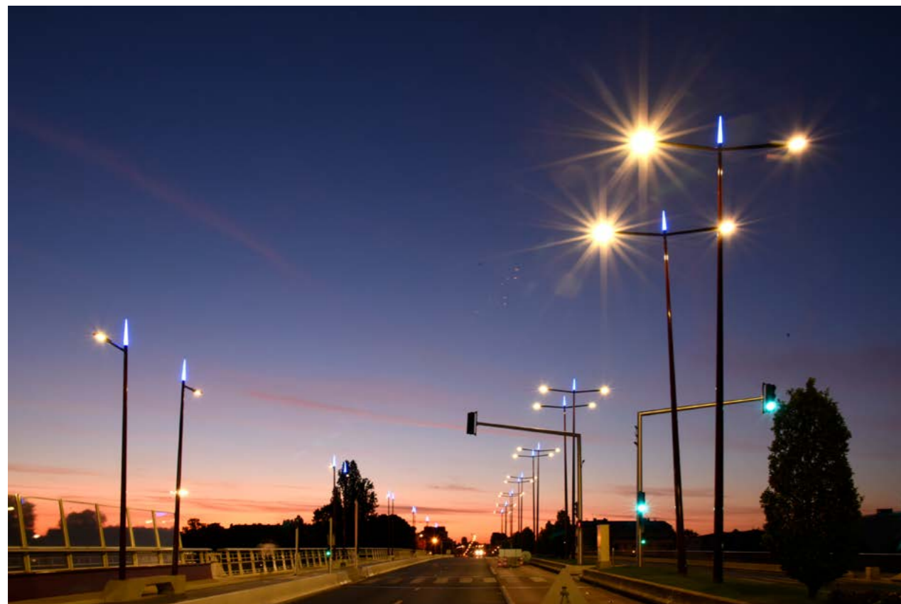
Luminaires Ragni installés sur le Pont de Choisy (Choisy-le-Roi, 94)
