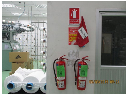
▲消火器と緊急避難用フラッグ
