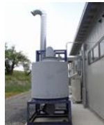
排ガス処理装置 [若柳タムラ製作所]
