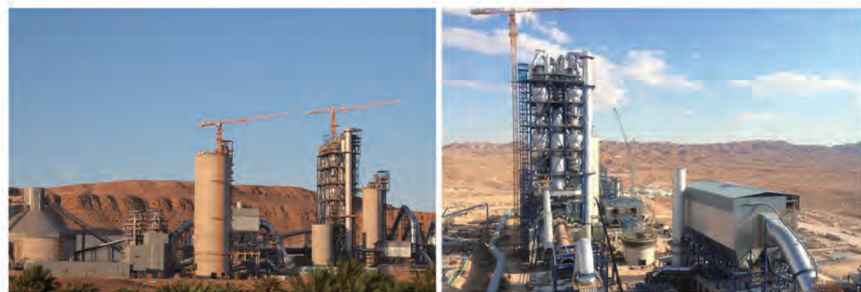
中材建设阿尔及利亚BISKRA项目施工建设 Algeria BISKRA project construction of CBMI
