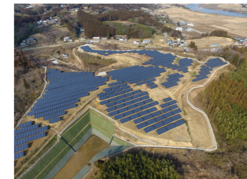
宮城登米太陽光発電所(宮城県)
