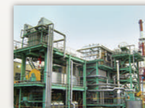
八潮工場バイオマス焼却発電設備
