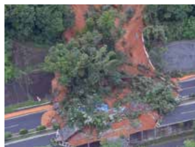
切土のり面崩落/九州道(新門司IC～小倉東IC)
