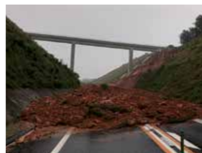
切土のり面崩落/東九州道(椎田南IC～豊前IC)
