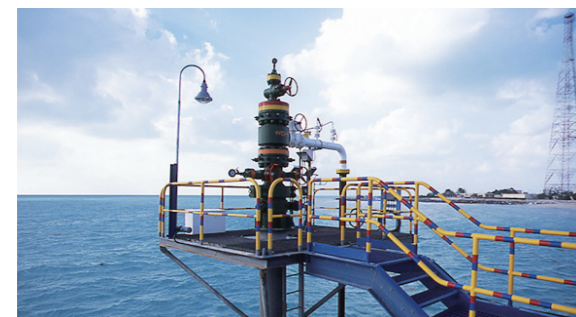
地下へ排水圧入を行う圧入井
