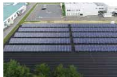
太陽光発電設備 （一関ヒロセ電機）
