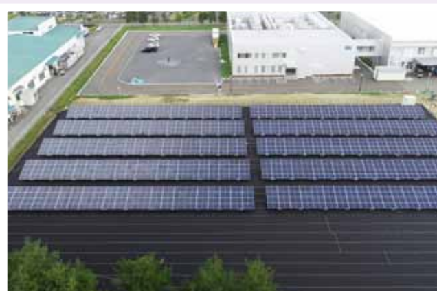
太陽光発電設備
