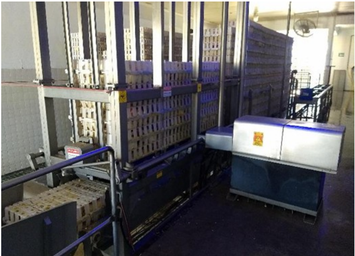
Instalación desapilador de jaulas - año 2018
