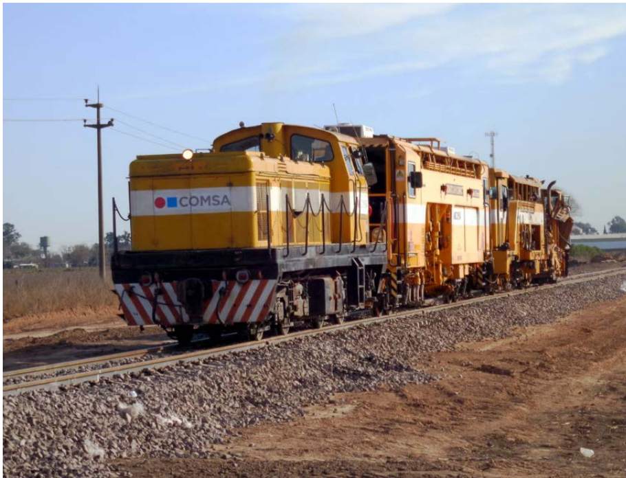
Renovación de vía tramo Monjes - Timbúes, en la provincia de Santa Fe (Argentina)
