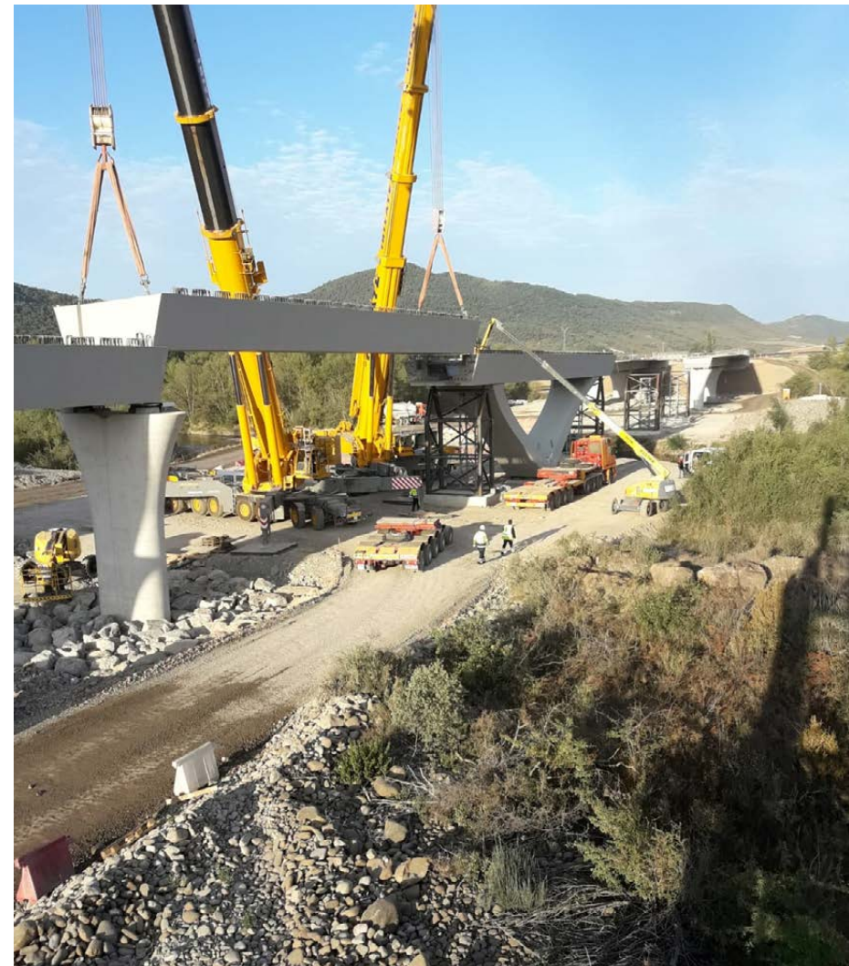
Obras de la construcción de la Autovía A21 Santa Cilia - Puente la Reina de Jaca, Huesca (España)
