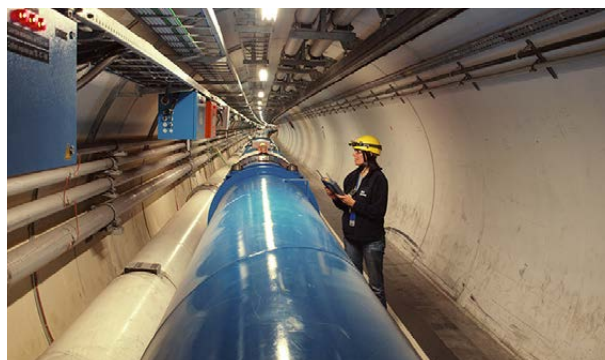
Mantenimiento de las instalaciones eléctricas de las sedes del CERN en Preveessin (Francia) y Meyrin (Suiza)
