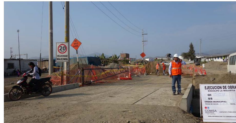
Construcción de un puente para la mejora de la movilidad en el municipio de El Rosario (Perú)
