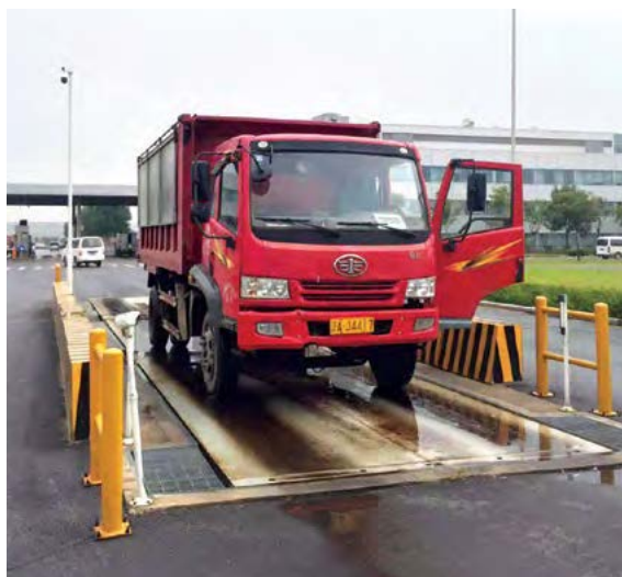
新安装的废弃物称重系统。
