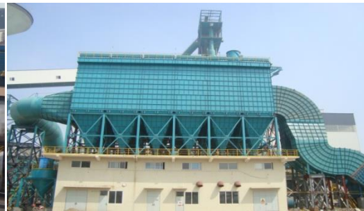
大高炉出铁场除尘
