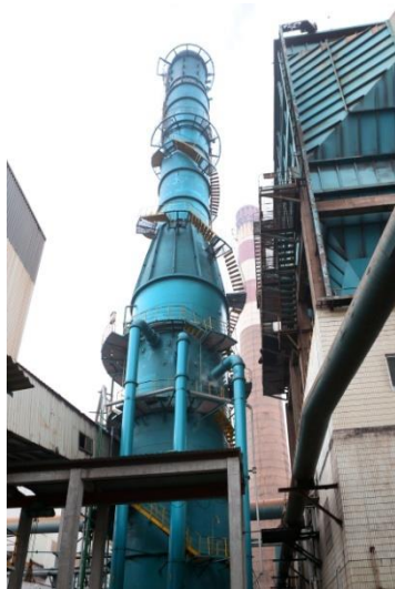
#3 烧结机头脱硫塔
