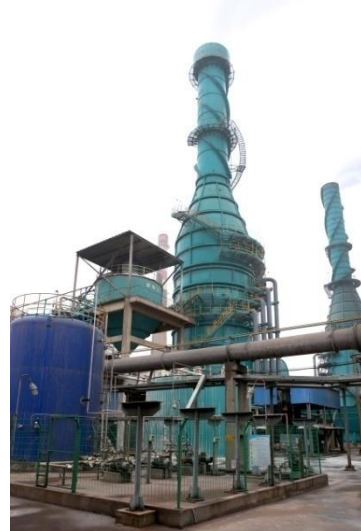
热电厂脱硫塔
