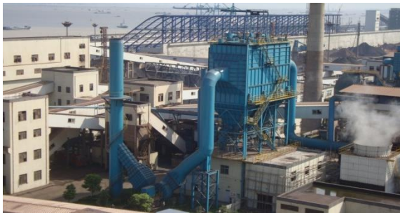
1#高炉矿槽电除尘
