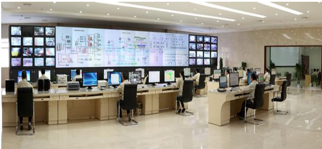
公司能源管控中心
