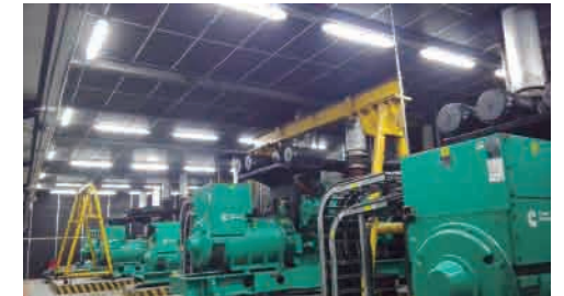
Nueva iluminación central de generación diésel Inírida.
