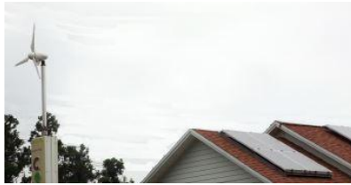
풍력·태양광 발전 설비
