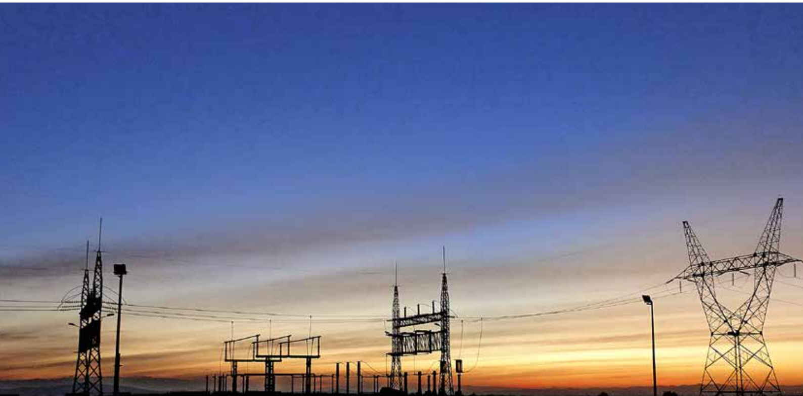
Oscurciendo - Subestación Mazocruz, bahía Kenko. La Paz Categoría Técnica. Foto: Diego Molina
