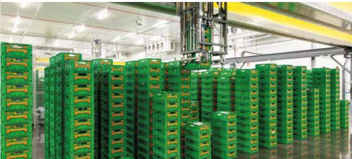
Sistema de Picking Puente Grúa (PPG) en el bloque logístico de Guadix, Granada.
