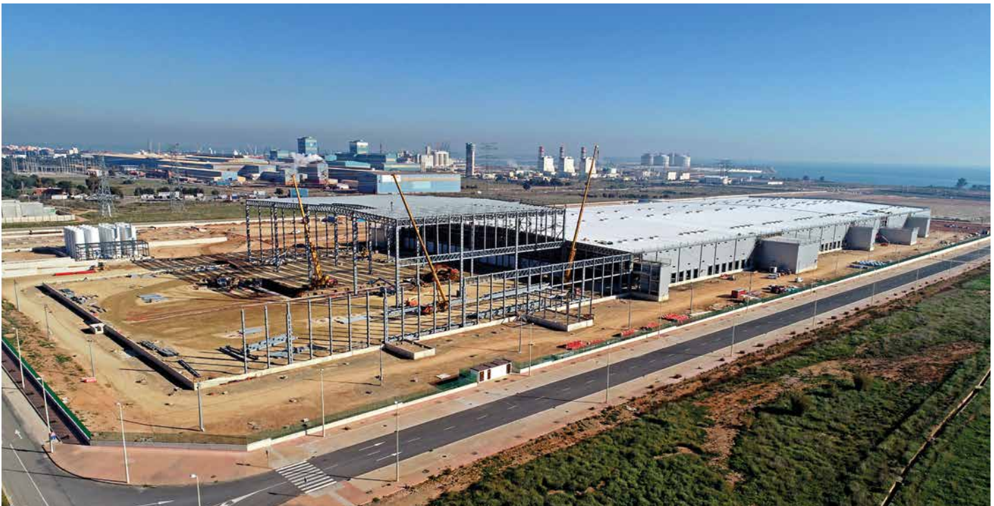
Fotografía aérea de la construcción del bloque logístico de Parc Sagunt, en Sagunt, València.
