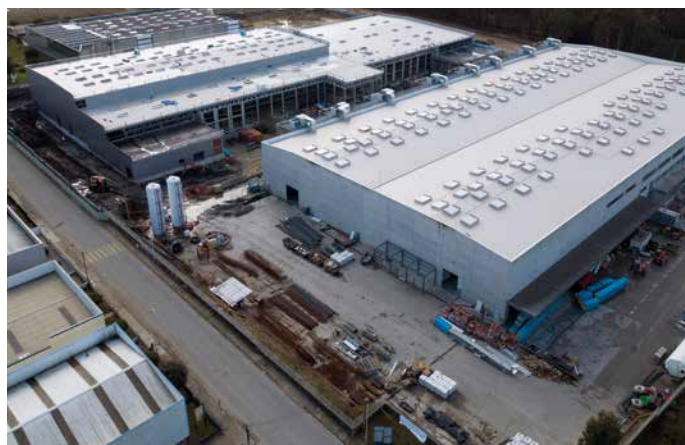
Fotografía aérea de la construcción del bloque logístico en Póvoa de Varzim, Porto.
