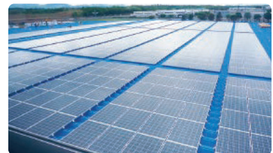
工場屋根上に設置した太陽光パネル
