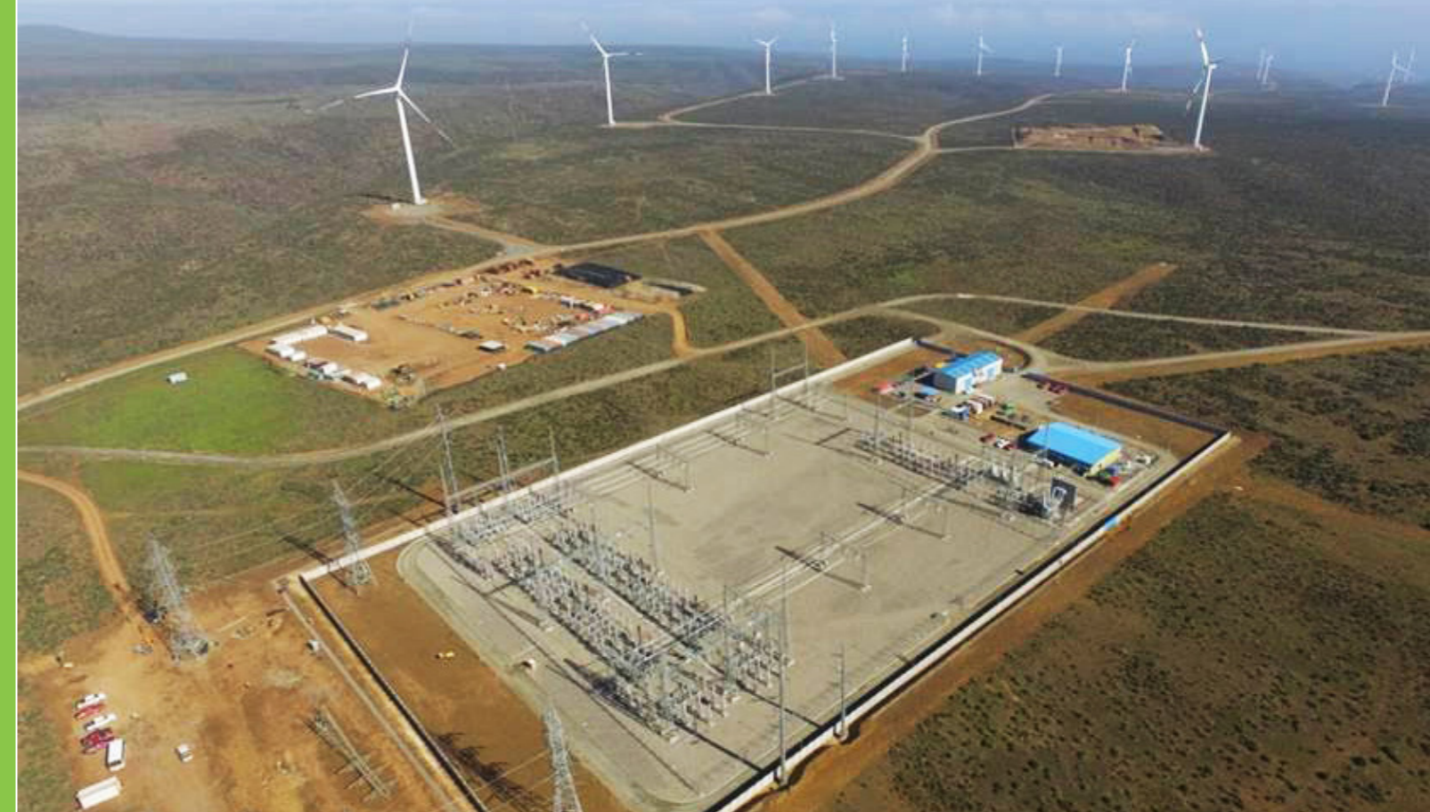
Movement at the (sub)station - Punta Sierra energised
