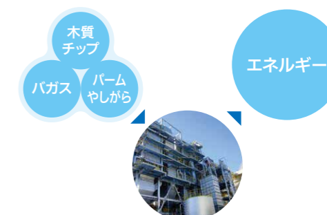
バイオマス発電プラント
