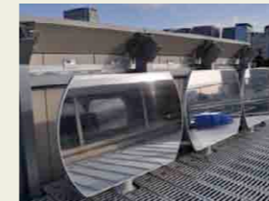
自然光採光(太陽追尾装置)
