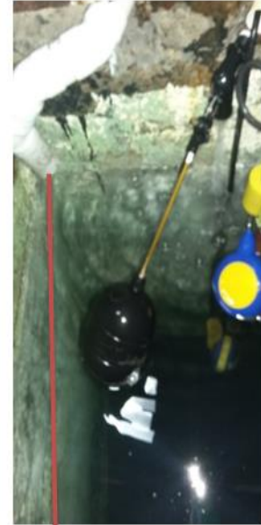
CAIDA DE AGUA PLUVIAL
