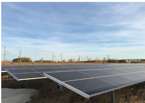
Centrale photovoltaïque AIREFSOL Energies des Mûriers (communes de Lapalud et Lamotte-du-Rhône dans le Vaucluse) ©EOLFI
