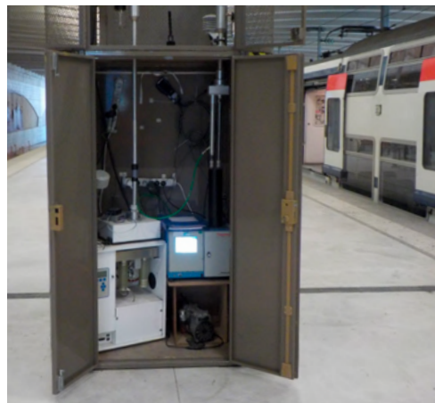
Baie de mesures des particules et métaux dans l'air au niveau du quai de la gare de Cergy-le-Haut (RER A) ©AEF
