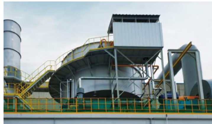
울산 도장42공장 RTO
