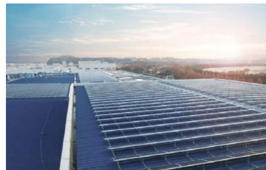
남양연구소 태양광 발전설비
