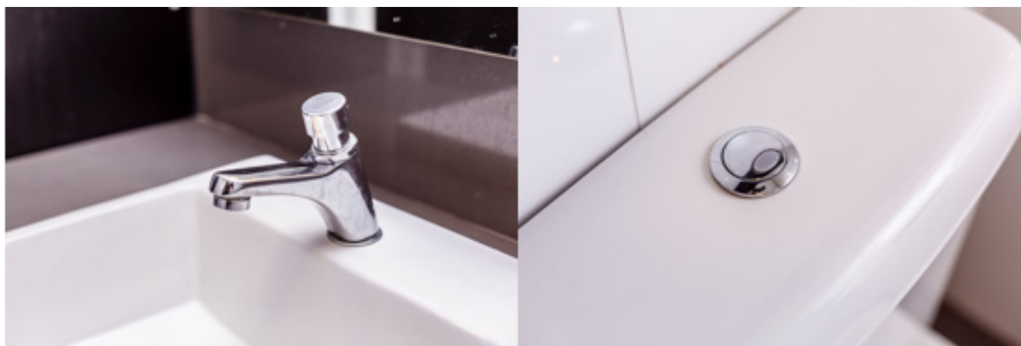
Torneira e descarga instaladas nos banheiros sociais da sede do RV&LC, em Belo Horizonte, desde 2018..
