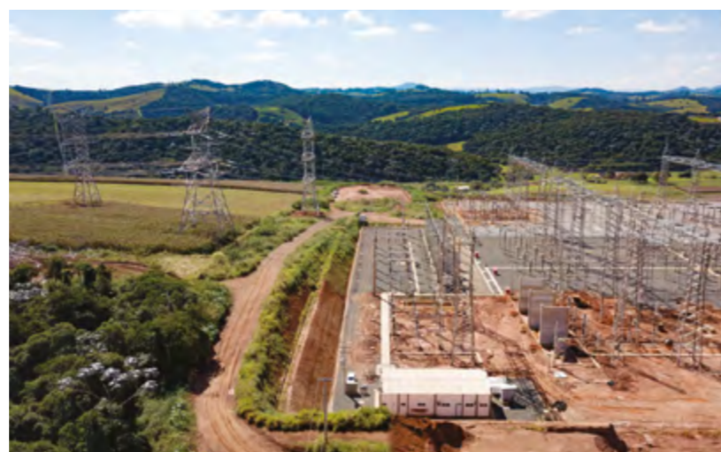
Subestação - Fernão Dias
