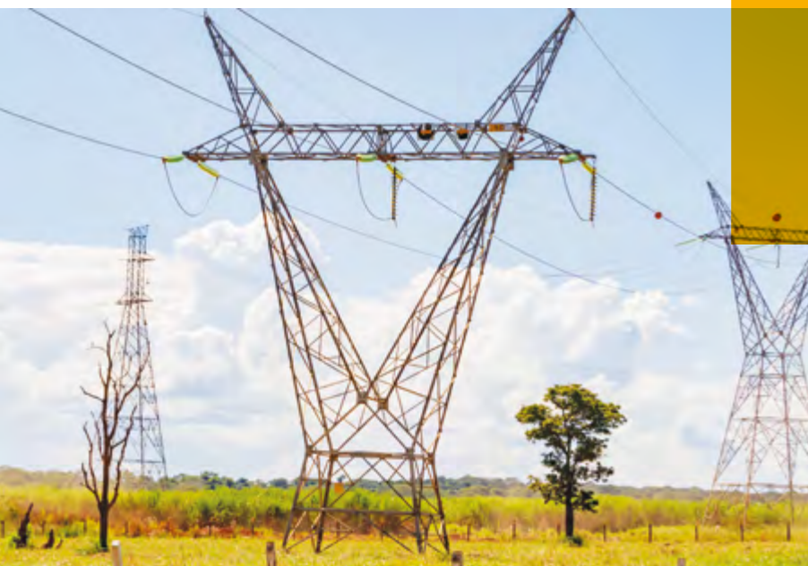
Subestação - BQC Barra dos Coqueiros
