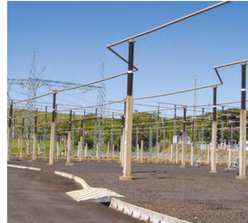
Subestação - USIM Itumbiara
