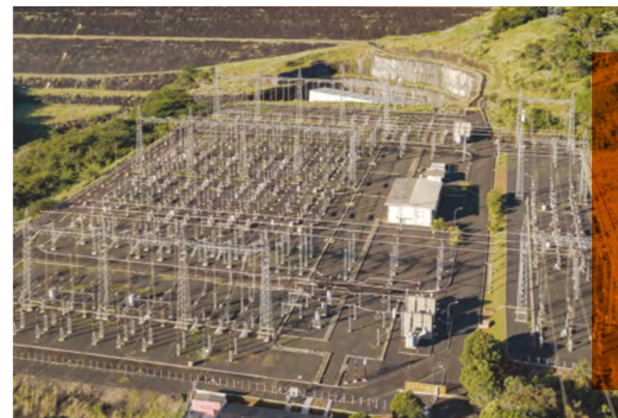
Subestação - Nova Ponte
