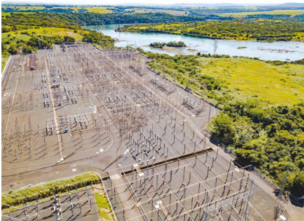
Subestação - USIM Itumbiara
