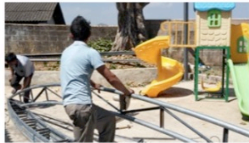
“成长计划”云南省临沧市镇康县塘尚水幼儿班室外活动棚正在施工中
