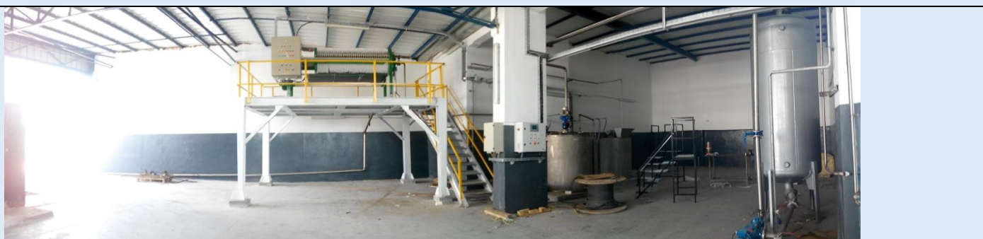
Sludge processing unit -Unité de traitement de boue lancée en 1 er avril 2016 – inaugurée en 19 mai 2016 par le ministre de l’environnement et développement Durable Monsieur Néjib Derouich. On 1st april 2016, We commissioning the new sludge drying system with filter press of the Wastewater Treatment Plant (WWTP)
