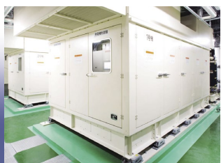
ガスエンジンCGS
