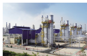
ペトロナス ベナピサン(マラッカ) コージェネレーションプラント プラント設備(マレーシア)
