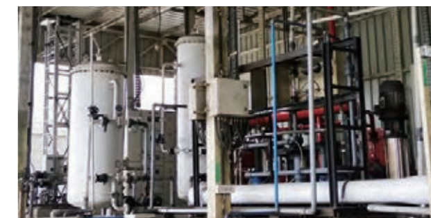
DM水処理タンクとRO処理施設
