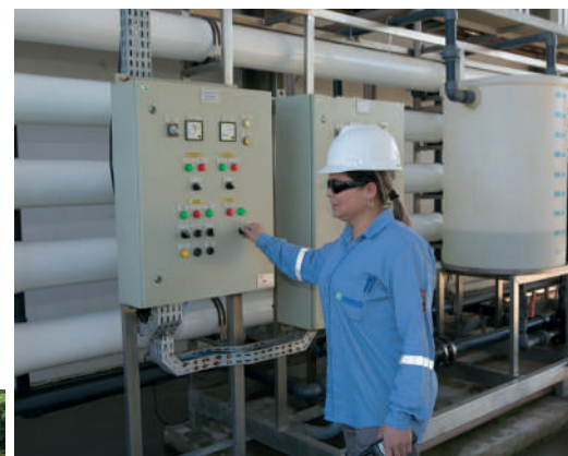
COLABORADORA UVS ESSENCIS - TRATAMENTO DE EFLUENTES
