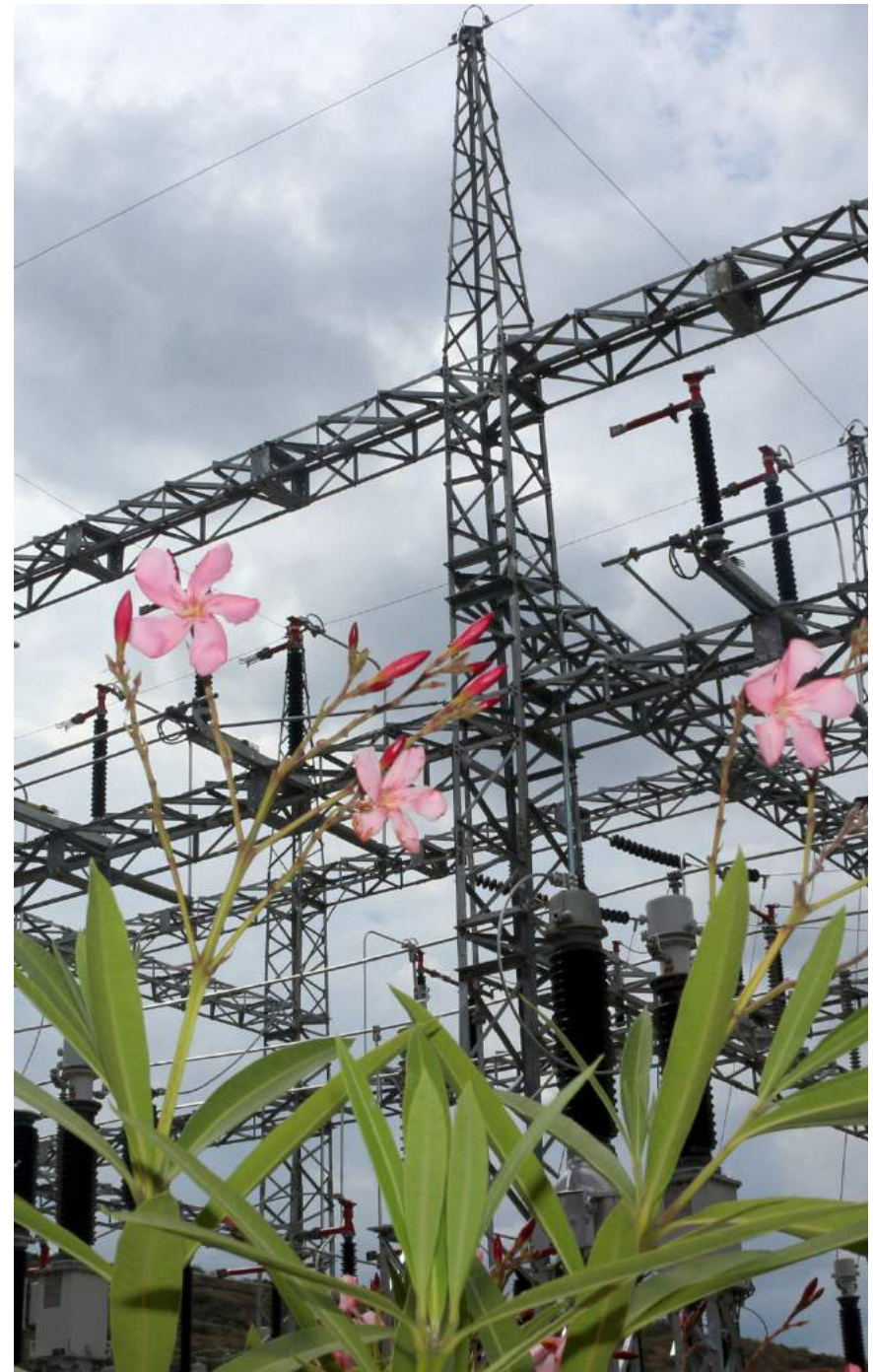
FOTO: SUBESTACIÓN ALTO DE RICAURTE
