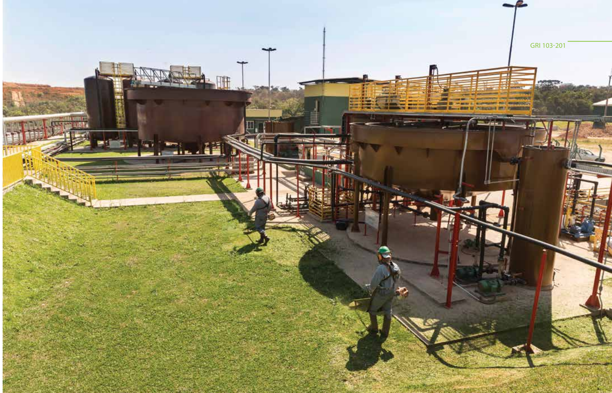
Estação de Tratamento de Esgoto (ETE): resultados combinados entre frentes de negócio equilibraram desempenho econômico
