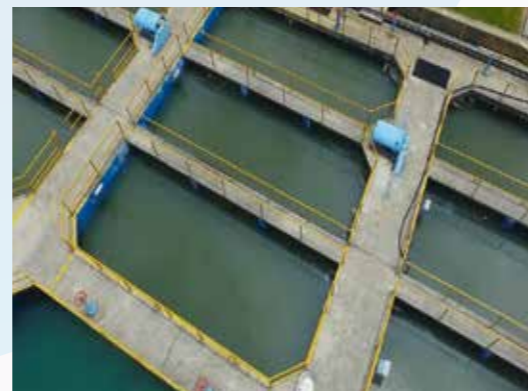
Tanque de Reserva Planta Troje
