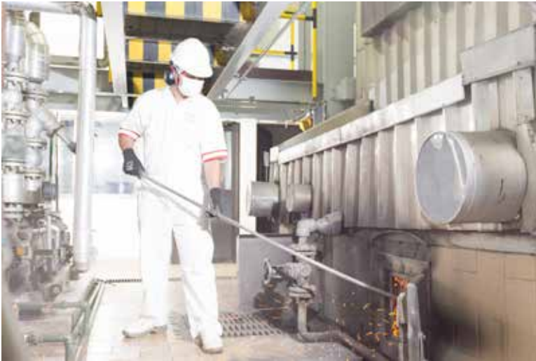
Planta generadora de vapor que utiliza biomasa del proceso de extracción de café soluble, Negocio Cafés, Colombia.
